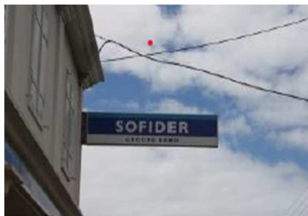
Enseigne drapeau dont la saillie est supérieure au 1/10 e de la distance par rapport à la voie Rue Labourdonnais
