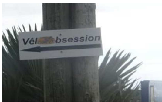
Dispositif installé sur poteau de télécommunication Chemin de la Roseraie
